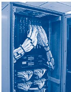
Figuur 6. Patchkast: verbindingen met netwerken op meerdere locaties.
